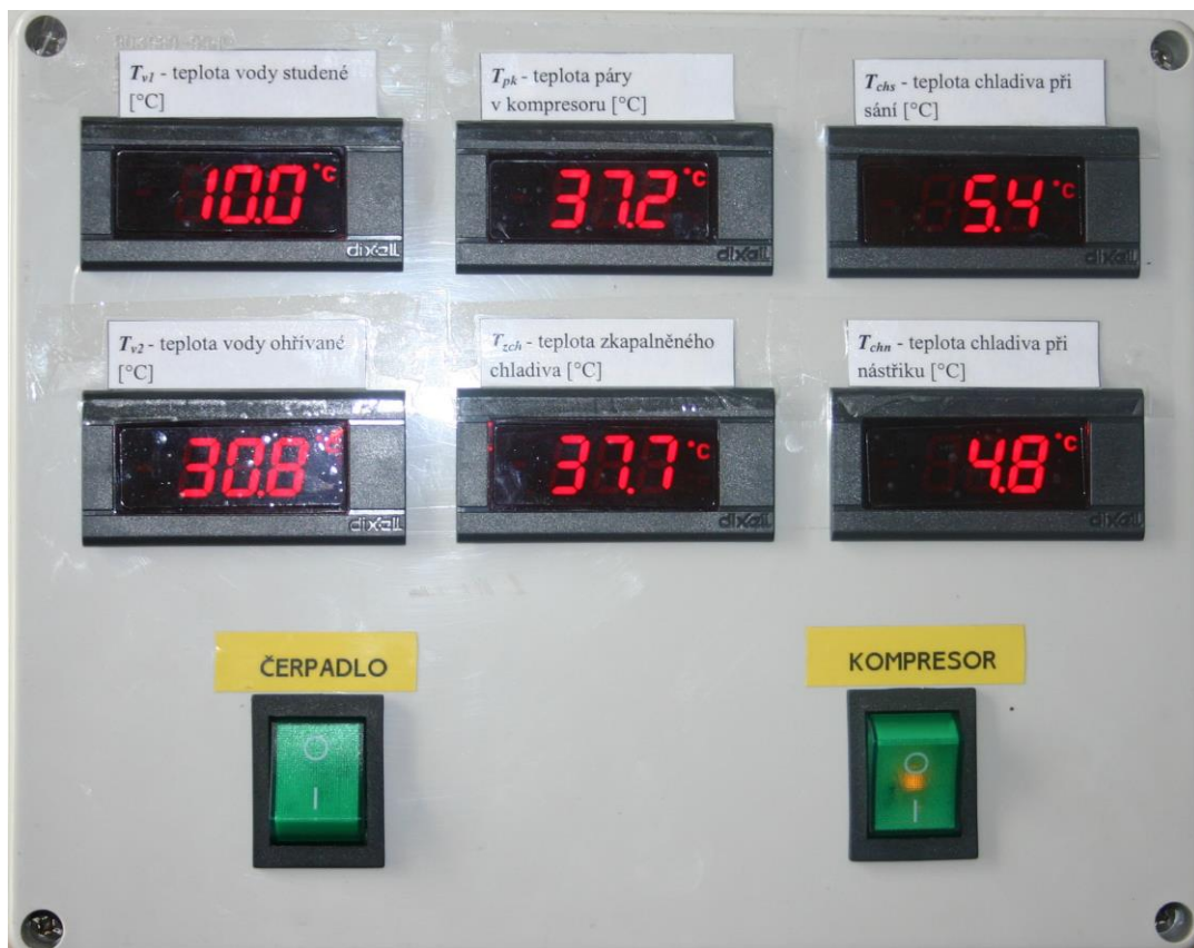
Obr. 4: Ovládací panel pro zapnutí kompresoru a čerpadla (pro rovnoměrné rozložení teploty v nádobě s vodou kondenzátoru). Zobrazené teploty přísluší různým částem tepelného čerpadla.
